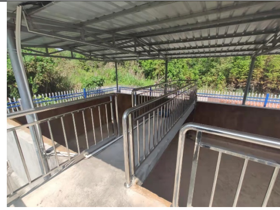
大陂湾地下水抽出处理设施
