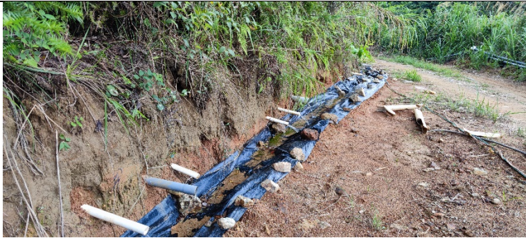
导流管和收液沟
