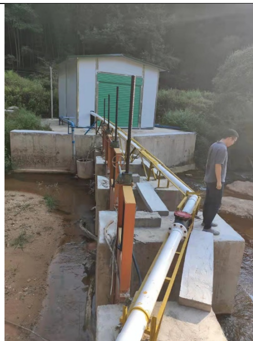
铜锣湾二截水坝及泵站
