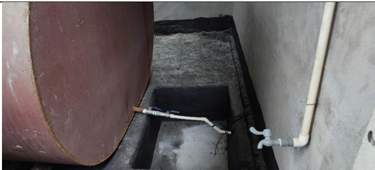
硫酸罐区 (防腐、防渗)
