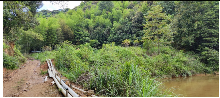
母液、浸矿液输送管线
